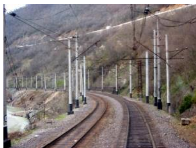
Линии контактной сети 3kV-DC, Грузия
