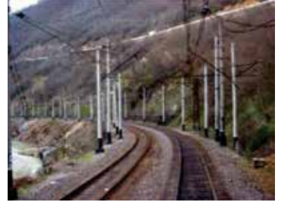
سلك كهرباء القطار ضغط عالي 3 DC kv- جورجيا
