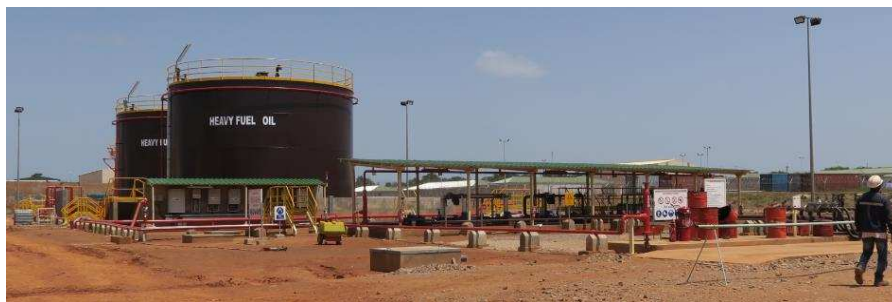
Figure 3 : Vues de la centrale thermique existante et du stockage HFO
