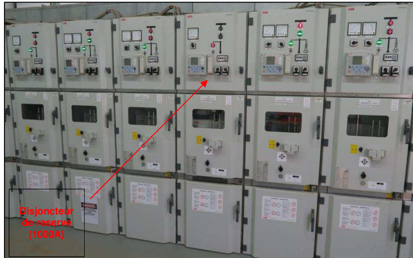
Figure 22: Tableau de génération de la Mine avec disjoncteur de réserve
